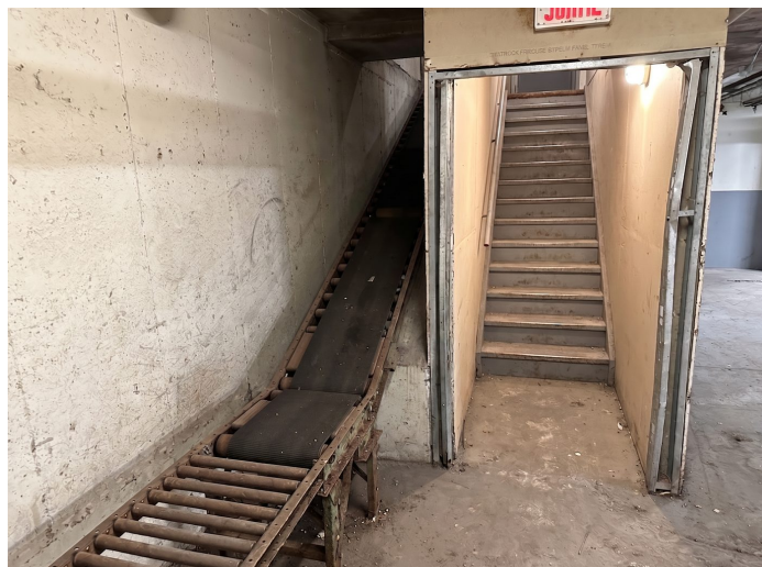
Convoyeur reliant le rez-de-chaussée au sous-sol / Conveyor linking the ground floor to the basement
